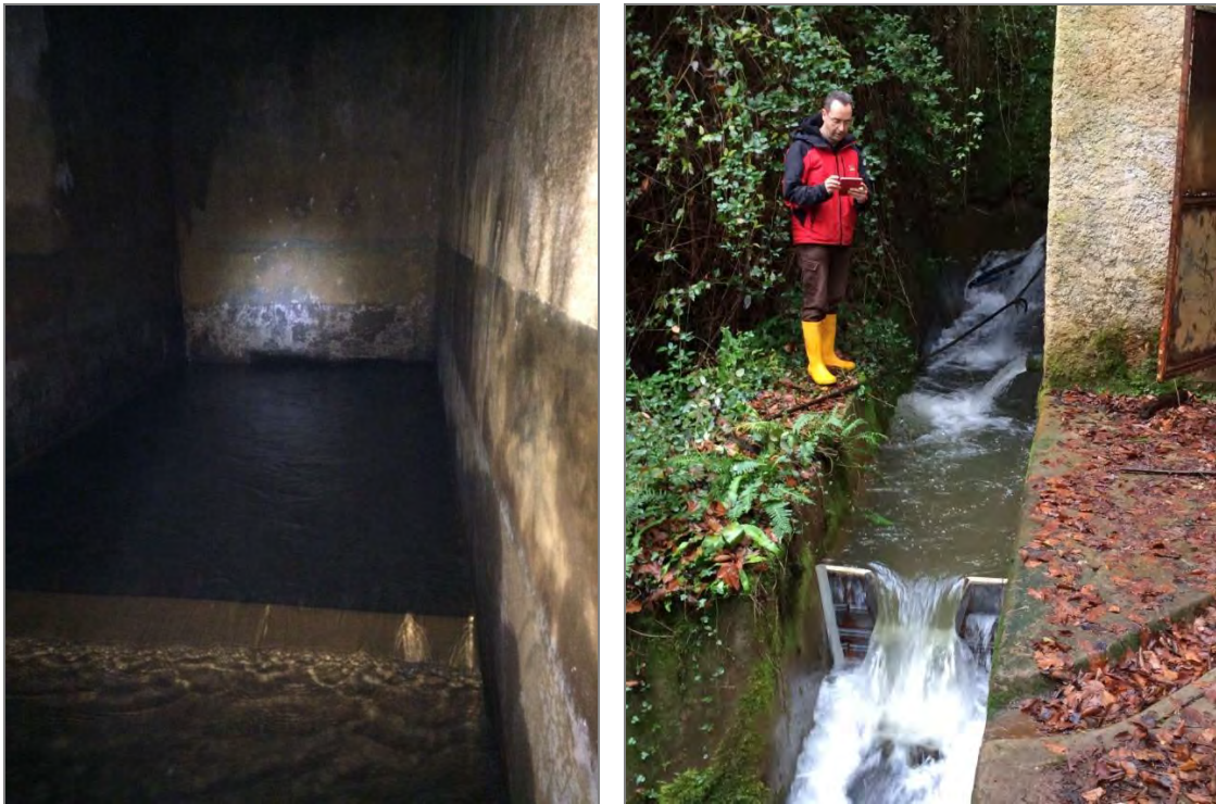
Figura 2.13. Sorgente Molini di Sant'Anna (VSMSA): A sinistra: interno del bottino di presa completamente allagato durante un evento di piena; a destra: il canale di scolo della sorgente.
