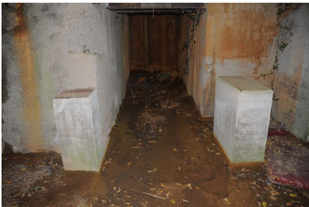
FANGHI RESIDUALI ALL'INTERNO DELLO STABILIMENTO
