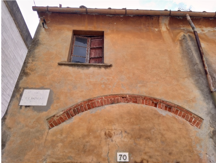
Fig. 1. Esempi di colature, patine e macchie sulla facciata di un edificio.
