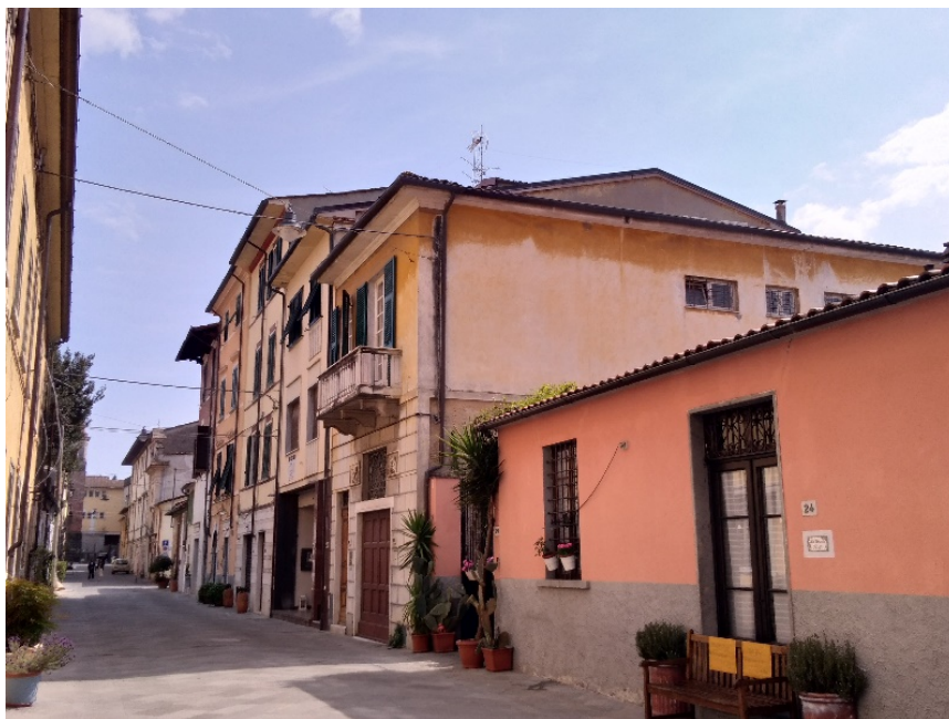
Fig. 2. Esempio di alterazione cromatica. Sul fronte laterale dell'edificio è ben evidente lo scolorimento e dilavamento della tinteggiatura, il cui colore ocre è visibile solo nella fascia sottogronda più riparata dall'irraggiamento solare e dall'azione dell'acqua.
